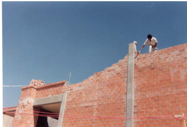
Figura 1.11 Condiciones de limpieza de muro cabecero
